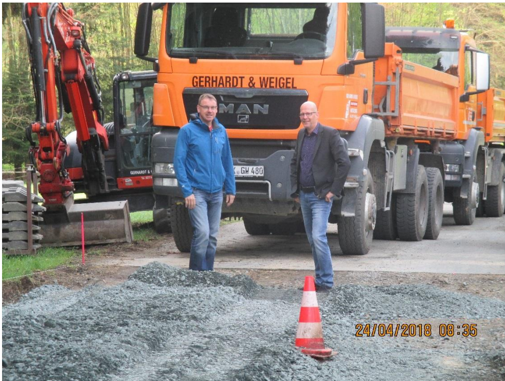
Bürgermeister Andreas Thomas machte sich Anfang der Woche mit Torsten Dittmar von der Bauabteilung vor Ort ein Bild von den laufenden Straßenbauarbeiten.
