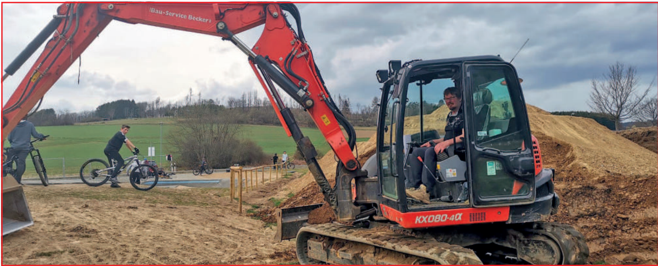
Thomas Becker (im Bagger) übernimmt persönlich die Baggerarbeiten für die neue Dirtline.
