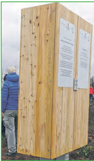
Schaltschrank aus Lärchenholz mit Info-Tafeln.
