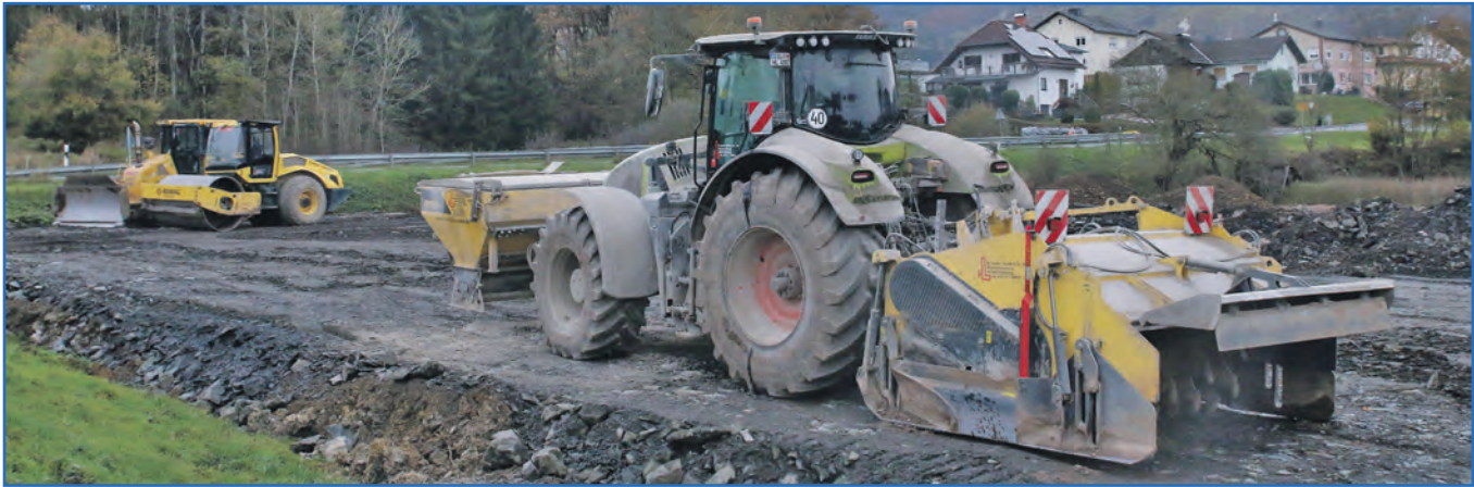
Die Fläche, auf der das neue Feuerwehrgerätehaus Mandeln gebaut werden soll, nimmt langsam Formen an. Es ist die größte Investition der Gemeinde im kommenden Jahr.
